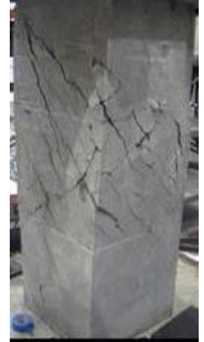
Kolonda burulma çatlakları
