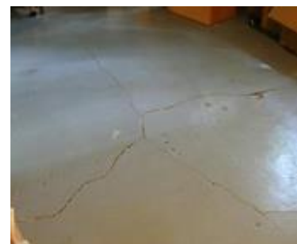
Döşemede büzülme çatlağı
