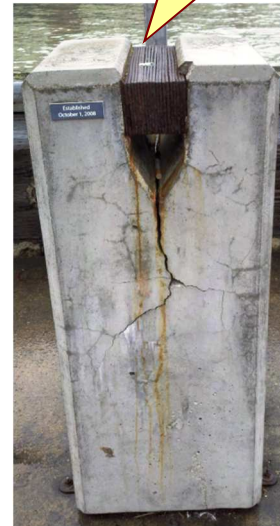
Paslanan çelik şişer, betonu çatlatır. Gönderen: Yusuf Levent TOPÇU, 2016
