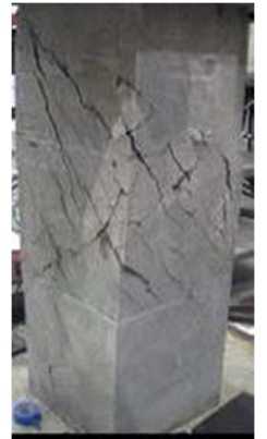
Kolonda burulma çatlakları
